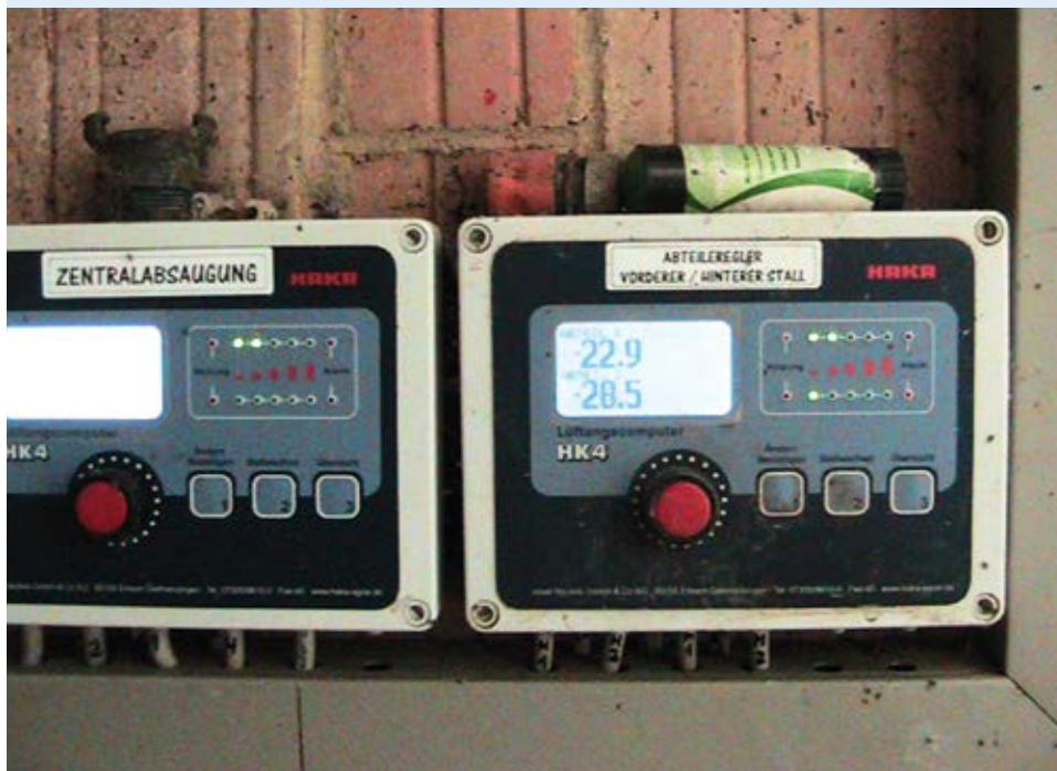
Abb. 46: Lüftungssteuerung eines Ferkel- aufzuchtstalles
