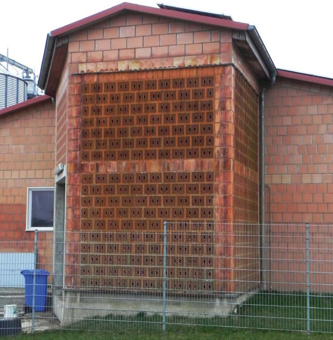
Abb. 45: Kühlturm an einem Schweinemaststall
