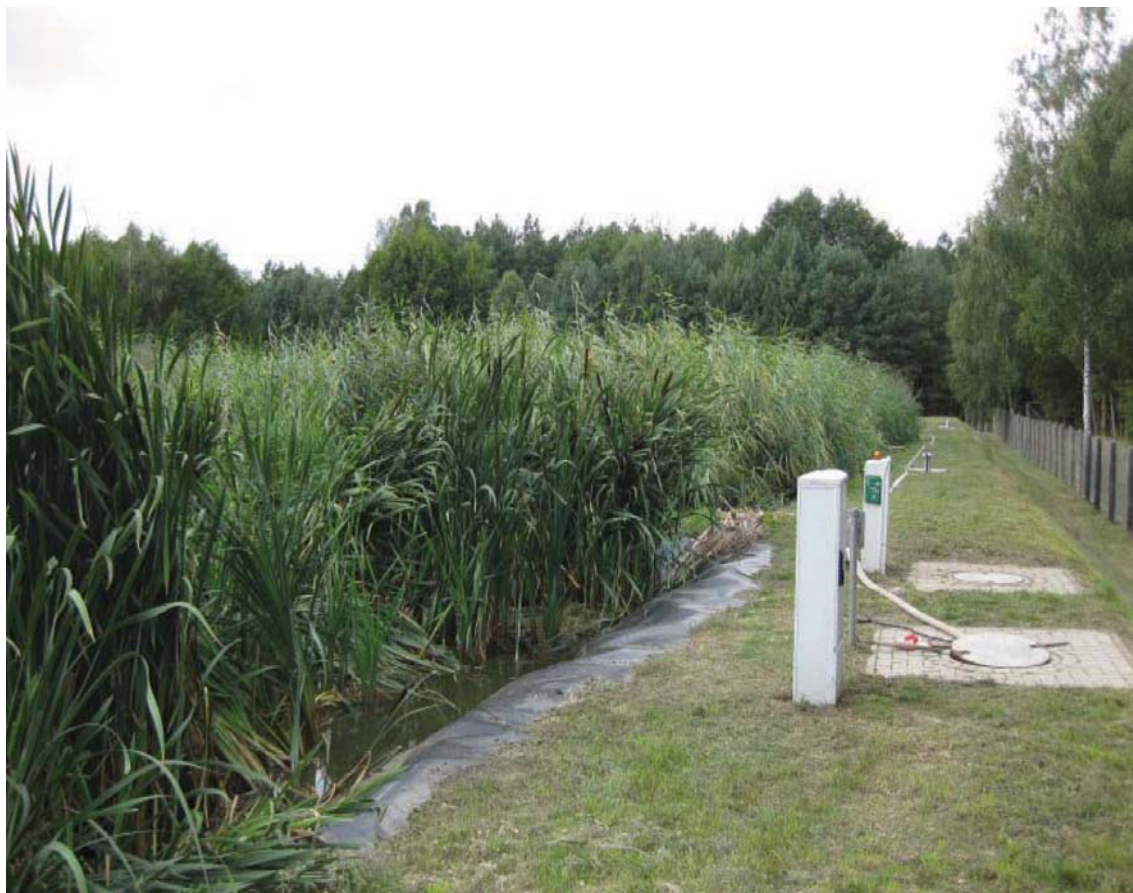
Abb. 10: Pflanzenkläranlage Netzeband (Ausbaugröße: 500 EW)
