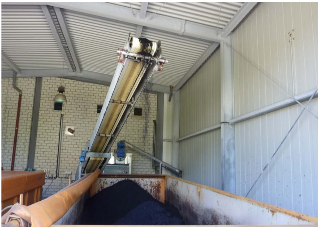
Abb. 11: Abwurf von entwässertem Klärschlamm auf der Kläranlage Potsdam-Nord
