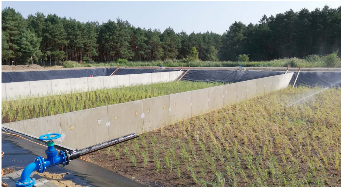
Abb. 16: Klärschlammvererdungsbecken der Kläranlage Friedland (Gubener WAZV)
