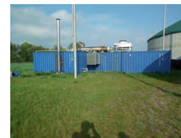
(j) BHKW-Container mit Zusatzheizung
