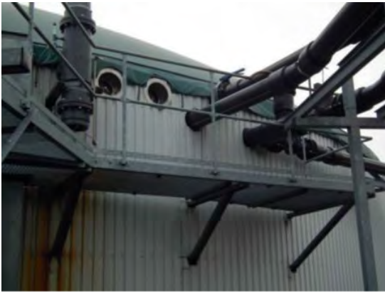
(a) Ingenieurskunst am Bau: wegen falscher Lochbohrungen wurden Bögen eingebaut, welche zu Verstopfungen führten
