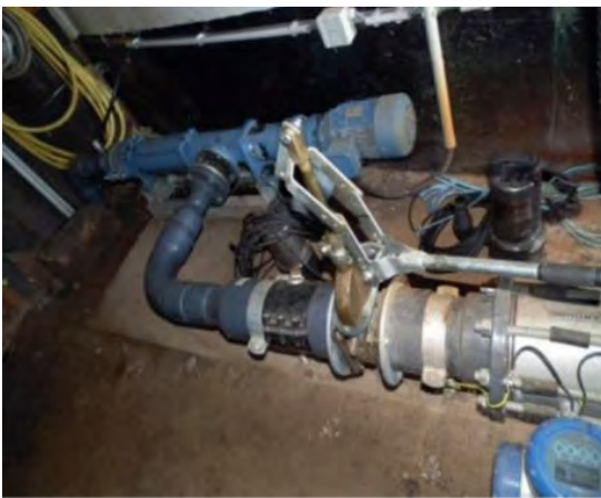
(b) Leitung wurde von der Pumpe verjüngt: dies führt zu erhöhtem Energieverbrauch und Verstopfungen
