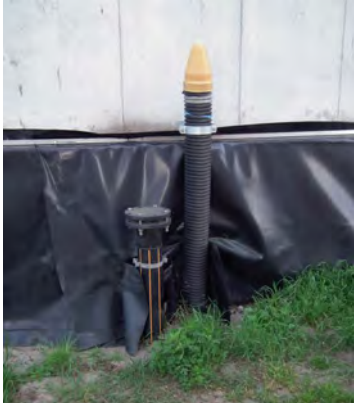
(a) nicht angeschlossene alte Heizleitung
