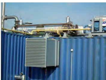
(i) BHKW vor der Erüchtigung
