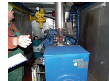
(k) altes BHKW 35% Wirkungsgrad
