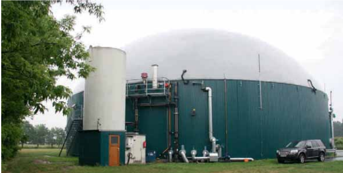
In diesem Fermenter wird Biogas erzeugt. Foto: Bauernzeitung
