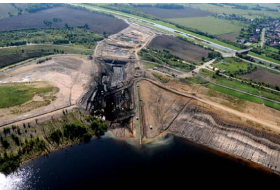
Trasse des HW-Einlaufbauwerks aus der Weißen Elster in den TBS Zwenkau als Hochwasservorsorge für Leipzig
