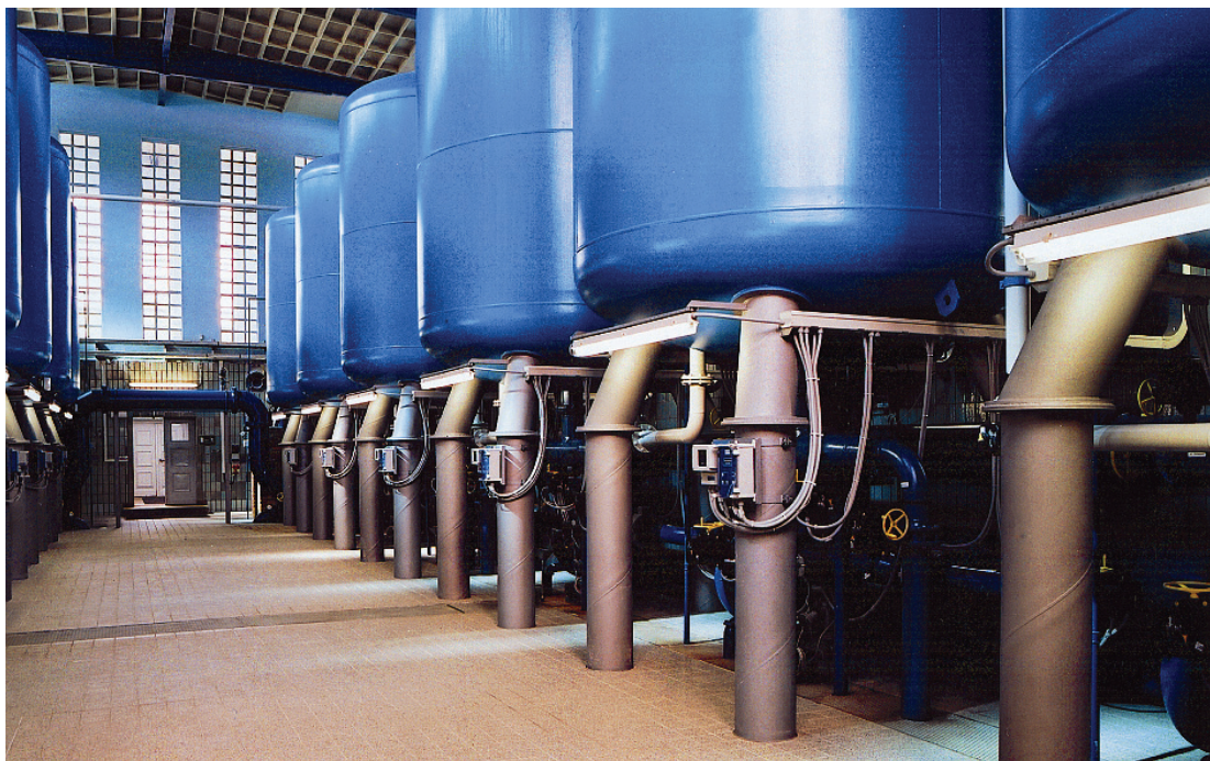
Abb. 9: Filterhalle im Wasserwerk Potsdam Leipziger Straße (Foto: EWP GmbH)
