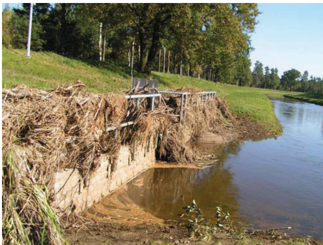
Abb. 6-1: Zulaufanlage von der Schwarzen Elster zum Neuwieser See nach dem Hochwasser Anfang Oktober 2010 (Foto: Schümborg)
